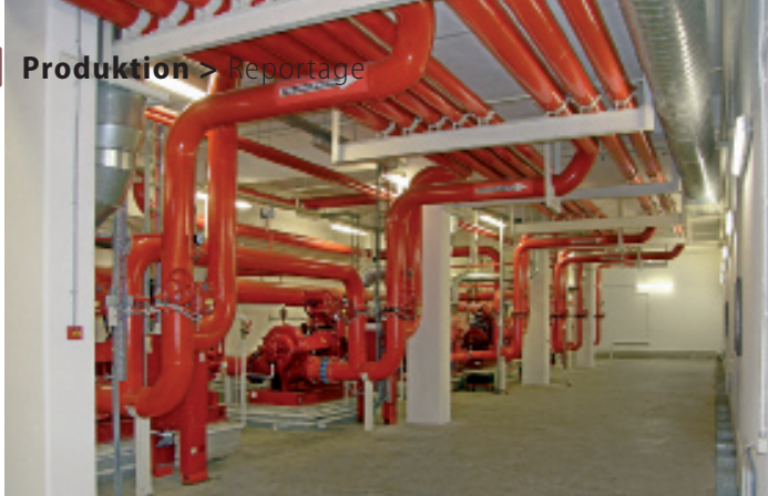
Bildquelle: Hoyer Brandschutz
